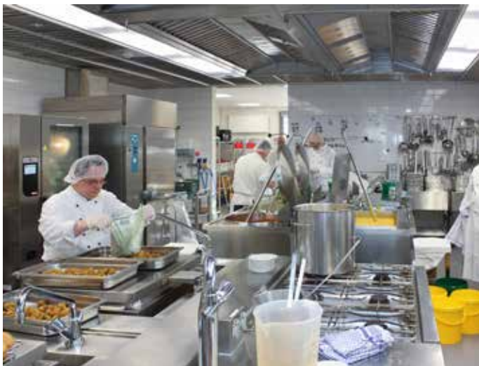
Die Produktionsküche ist gut ausgestattet, unter anderem mit mehreren Combidämpfern, die auch für das Niedertemperaturgaren von Braten genutzt werden.
